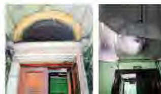
Забор воздуха над служебным входом и приточный воздуховод с внутренней стороны здания, 2023 год (фото Ирины Кузнецовой)
