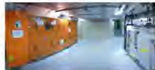
Одна из холодильных машин и приточно-вытяжная установка, 2019 год (© ООО «ЮНИКС»)
