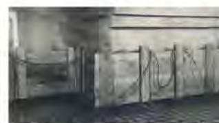
Разводка электрических в подвале здания, 1974 год (© СПб ГБУК «Государственный музей-памятник «Исаакиевский собор», 2023)
